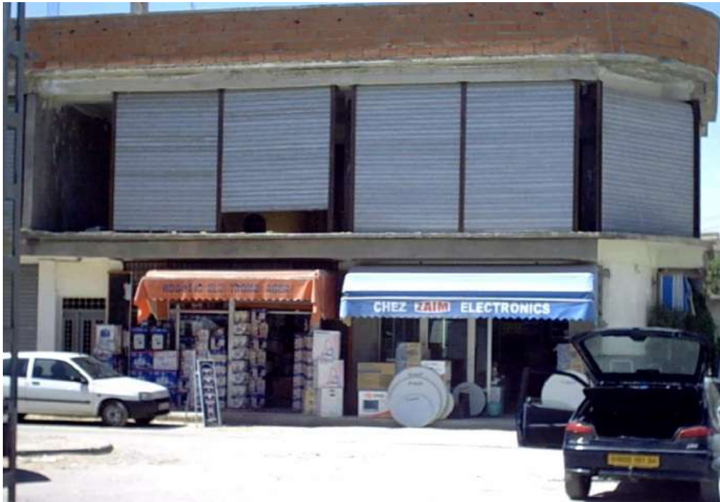
Photo 2 : Construction en chantier sans permis de construire, dédiée au commerce de gros (cliché M. Gherbi, août 2008).
