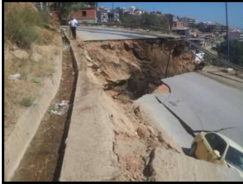
Figure 2- 11 Glissement de terrain a à Annaba dans le quartier de Sidi Aissa sur la bretelle qui va de Kouba à Ain Achir(Chaoui, 2014)
