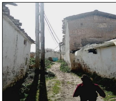
Figure 7. 67: effondrement des murs Source : auteure, 2023
