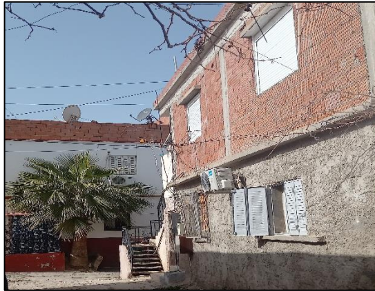
Figure 7. 65: modifications anarchiques Source : auteure, 2023
