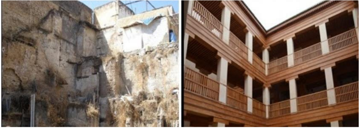
Figure 4. 2: Intérieur avant et après réhabilitation du Foundouk Chemmaine. Medina de Fès. Conseil Régional du tourisme de Fès.
