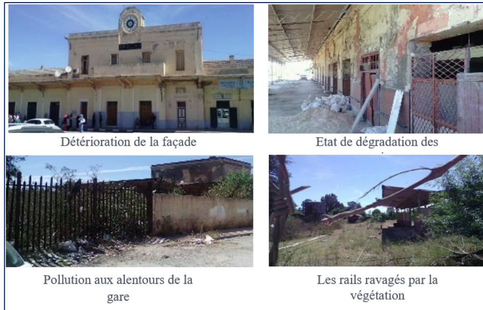
Figure 6.36 : Degré de détérioration des bâtiments et alentours du site
