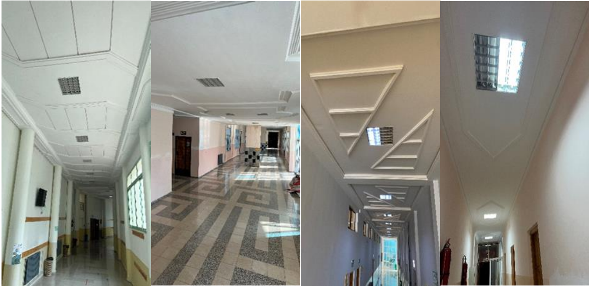
Figure 4.7 Photo des luminaires au niveau des facultés et institut. Source : auteure ,2024.
