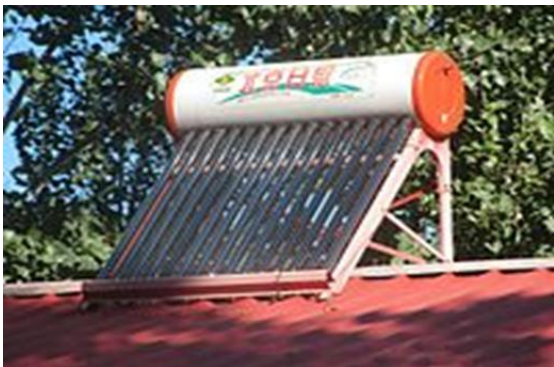
c) Chauffe-eau solaire
