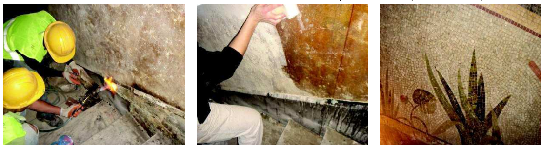
Brulage des murs pour la décapage de peinture y compris la nettoyage final manuellement.
