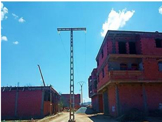
صورة رقم 3.6: مخالفة بناء السكن الفردي في
