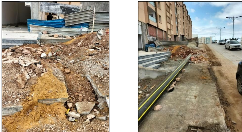
Figure 5.8 : Travaux du SONELGAZ au niveau des chaussées sans remise à l'état initial. Source : Auteur.
