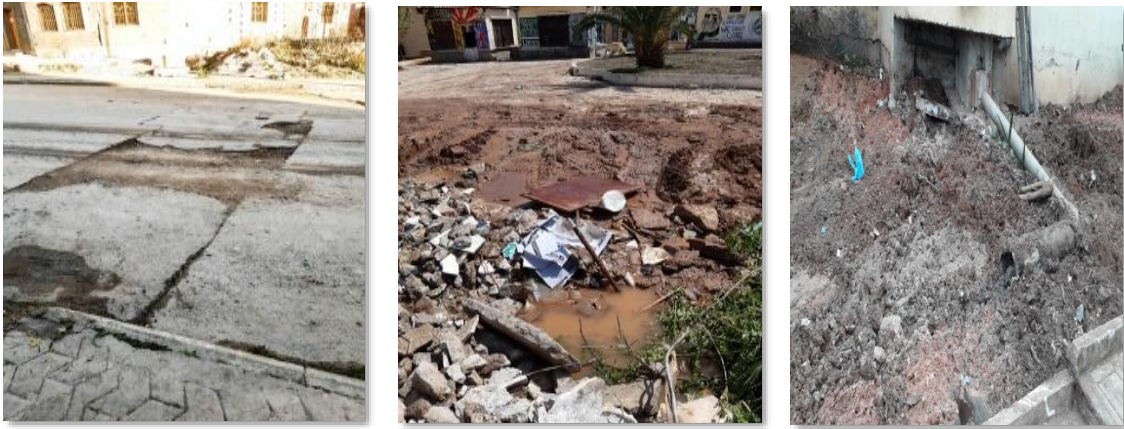
Figure 5.9 : Dégradation des vides sanitaires et des chaussées. Source : Auteur.
