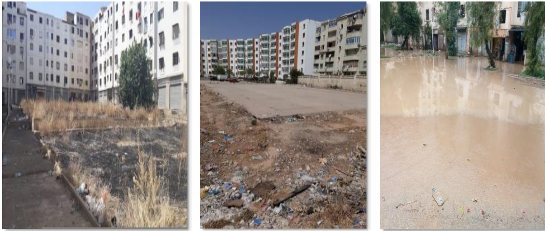
Figure 5.11 : Dégradation des aménagements extérieurs et stagnation des eaux pluviales. Source : Auteur.
