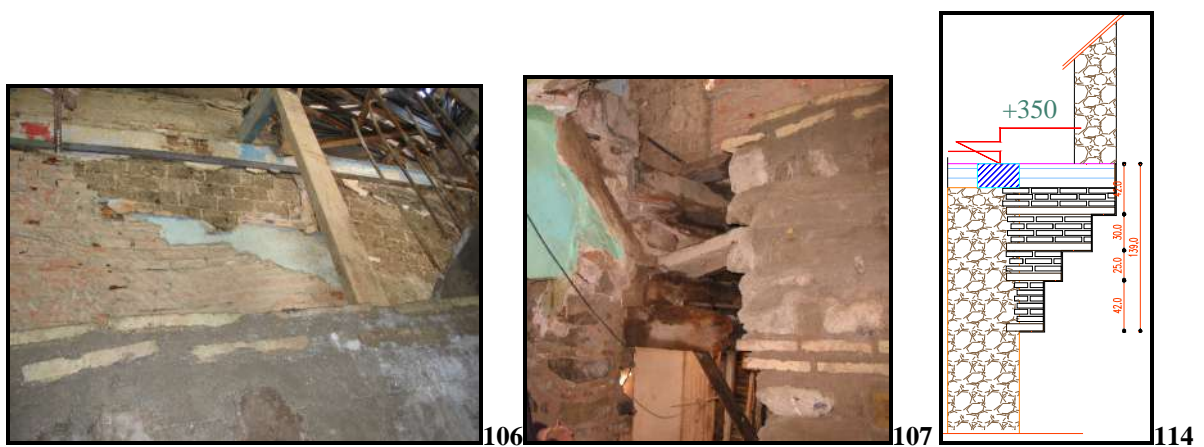
Photo 106 : Mur mitoyen maisons 19 et 19 bis, Mise en évidence de structure en brique terre crue. Photo 107 : Rempiètement des murs en maçonnerie banchée ( coffrage amovible, destiné à la construction des murs). Figure 114 : Détail de construction des consoles pour encorbellement.
