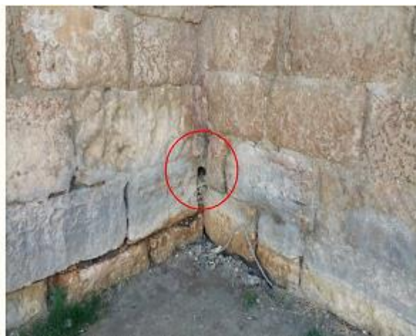
Figure 7.36 : Création des points d'évacuation des eaux pluviales en creusant les murs du rempart
