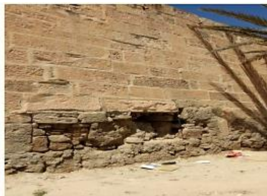
Figure 7.30 : Érosion différentielle des pierres
