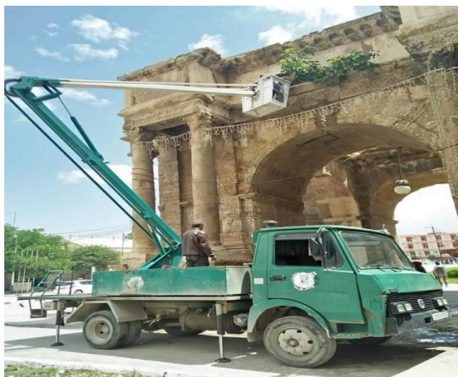
Figure 9.27 : Enlèvement d'une plante parasite enracinée dans l'attique de la façade Ouest de l'arc de triomphe de Caracalla
