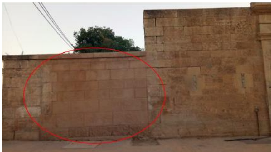
Figure 7.40 : Réparation d'un mur dégradé au niveau de la place Ennasr, en y appliquant un crépissage à base d'enduit décoratif
