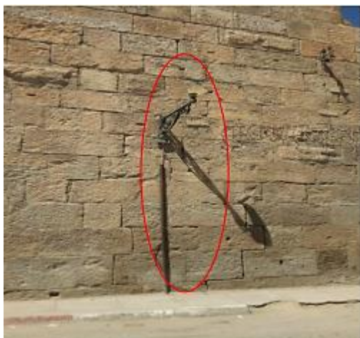
Figure 7.35: Aménagement désordonné des lampes d'éclairage installés directement dans le murs byzantin
