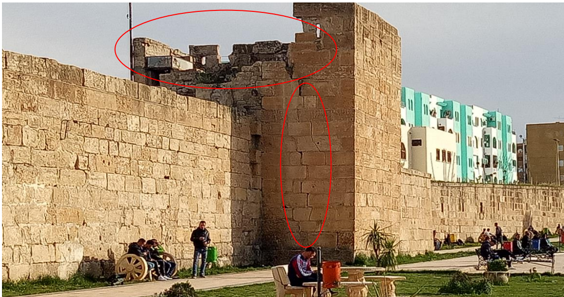
Figure 7.24 : Fissuration et effondrement partiel du sommet de la tour n°9 dans la citadelle byzantine de Tébessa
