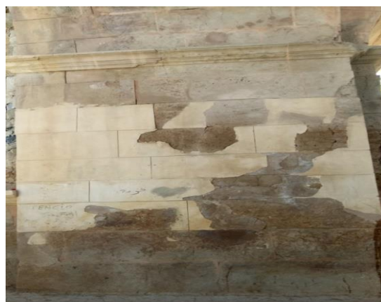
Figure 9.18 : Crépissage avec des matériaux inappropriés à l'intérieur de l'arc de triomphe provoquant une différenciation de la couleur entre la pierre d'origine et l'enduit rajouté
