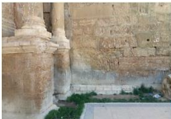
Figure 7.29: humidité bien visible dans la partie inférieure du rempart byzantin
