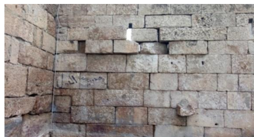
Figure 7.28: Déboitement des pierres à cause des altérations au niveau du mortier
