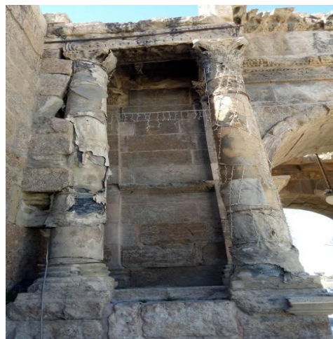
Figure 9.16 : Les restes du plâtre recouvrant les deux colonnes existantes dans la face Est
