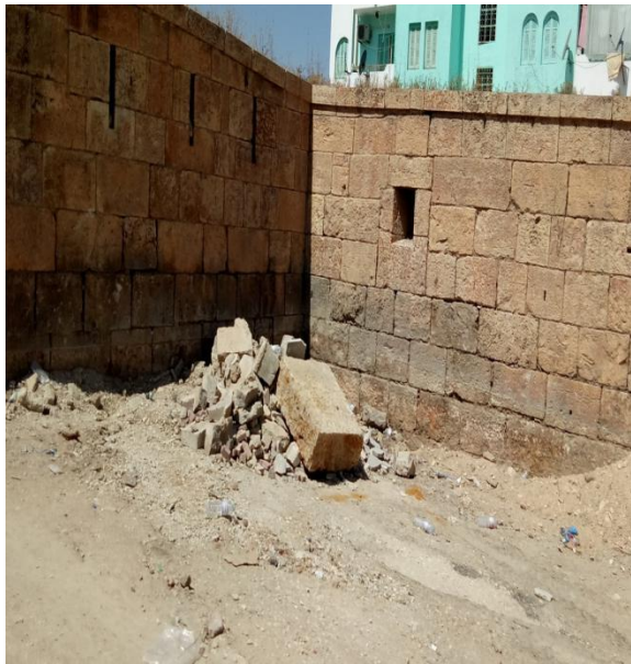
Figure 9.55 : Restes du chantier de réaménagement du centre historique contenant des fragments de matériaux divers y compris des pierres de taille
