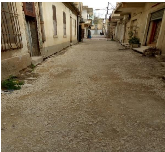
Figure 9.52: Rue a l'intra-muros avant réfection
