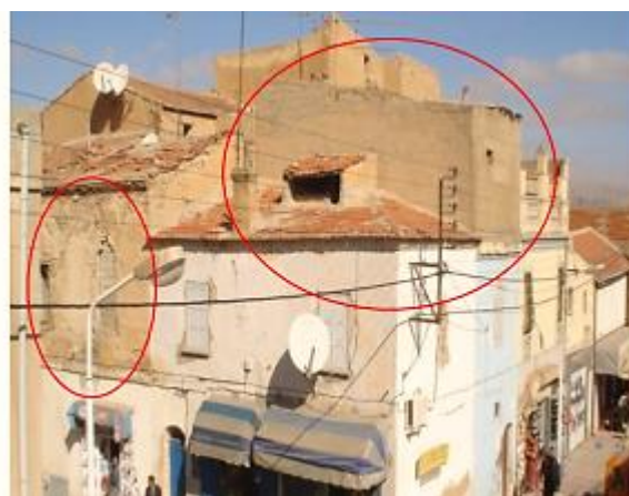
Figure 6.23: Délabrement du bâti colonial et surélévation illicite des habitations anciennes
