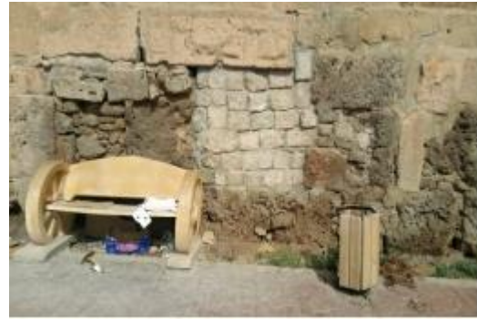
Figure 7.39 : Remplissage d'une partie de mur byzantin, dont les pierres se sont dégradées, en utilisant des pierrailles jointes à l'aide du mortier du ciment
