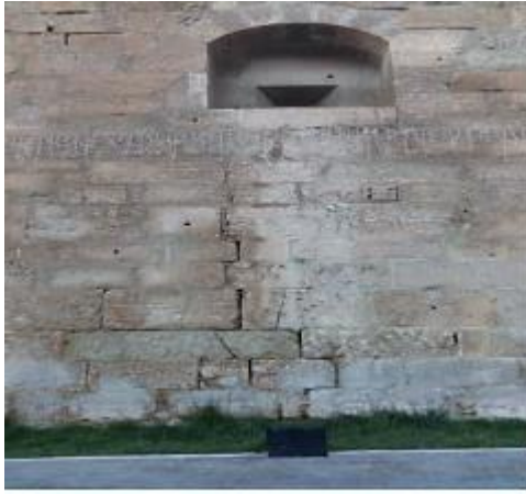
Figure 7.22 : Fissures au niveau de tours d'angle n°12 du rempart byzantin
