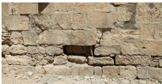
Figure 7.27 : Perte et dégradation des pierres dans le rempart byzantin
