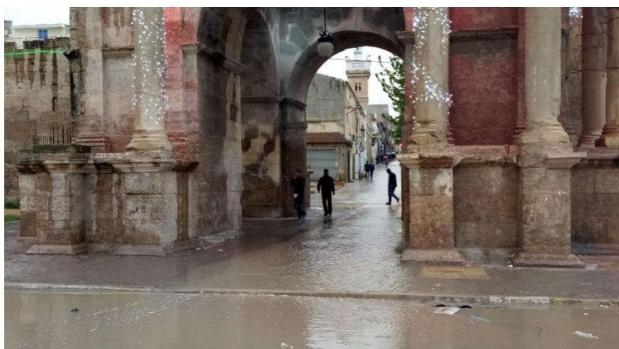
Figure 7.37: Réseau d'assainissement inefficace, provoquant des marécages au niveau de la porte de Caracalla
