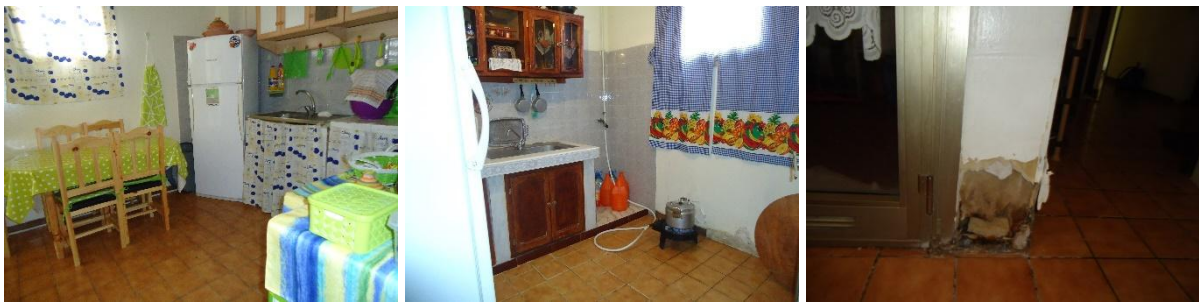
7-23. Appropriation de la cuisine, état lamentable du mur de la cuisine
