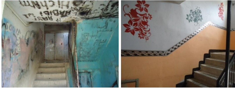
6-14. Une cage d'escalier d'un immeuble R+4. A droite une cage d'escalier entretenue
