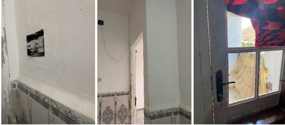
6-36. Mauvaise finition des espaces intérieurs
