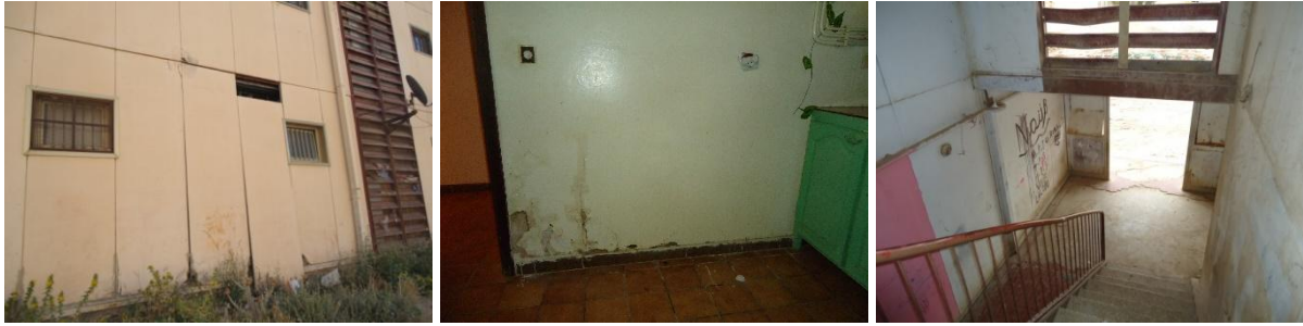
7-69. Détérioration des panneaux préfabriqués
