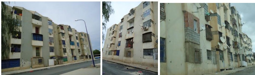
7-68. Couverture des séchoirs, et obstruction des façades
