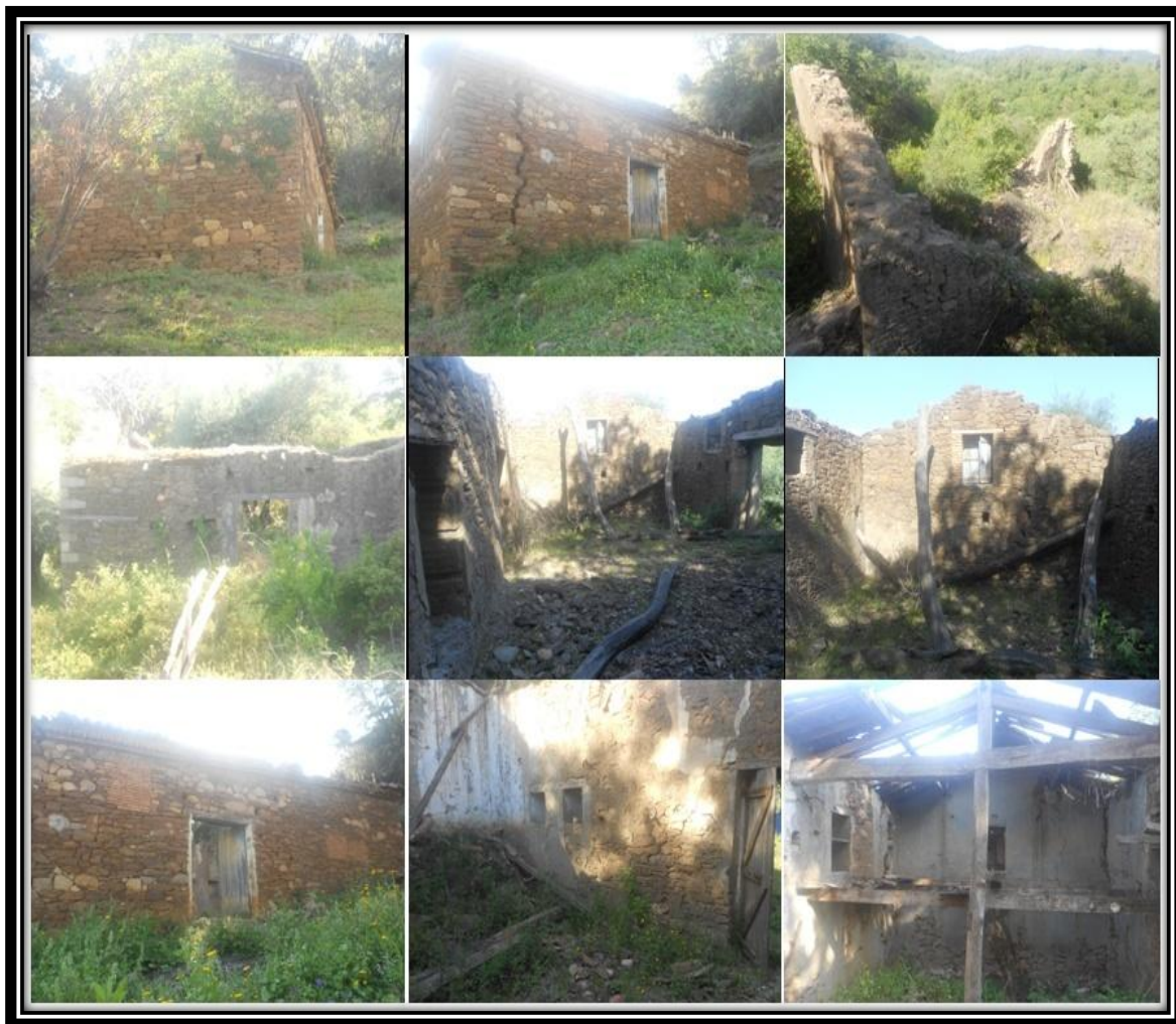
Figure 8. 15: Maisons vernaculaires en ruines, mechta Ouled Echelli (Mai 2022). Source : Auteure, 2024.
