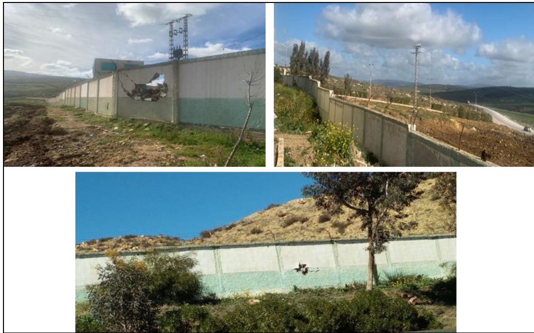
Figure n°07.11 : Etat de la clôture du CET de « Boughareb »
