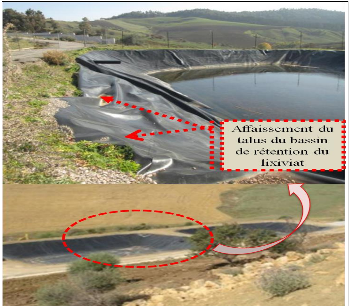
Figure n°07.08 : Rupture de l'étanchéité du bassin de rétention du lixiviat.
