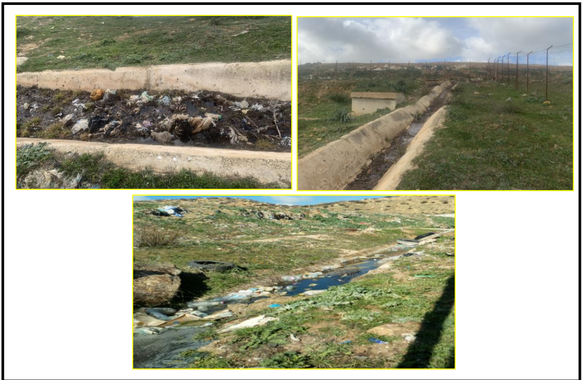
Figure n°07.17 : Etat des caniveaux de drainage des eaux à l'intérieur de CET « Boughareb »
