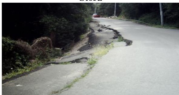
Photo n° 55 : Les glissements de terrain Stora
