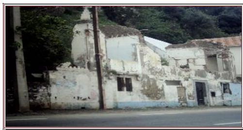
Photo n° 56 : Effondrement des constructions sous le poids d'un glissement de terrain corniche Stora
