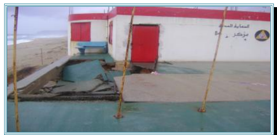
Photo n° 44 : Effondrement des trottoirs dû à l'érosion
