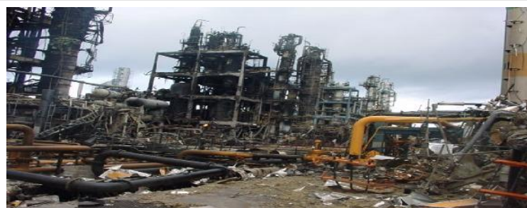
Photo n° 34 : Le complexe GL1/K après l'explosion
