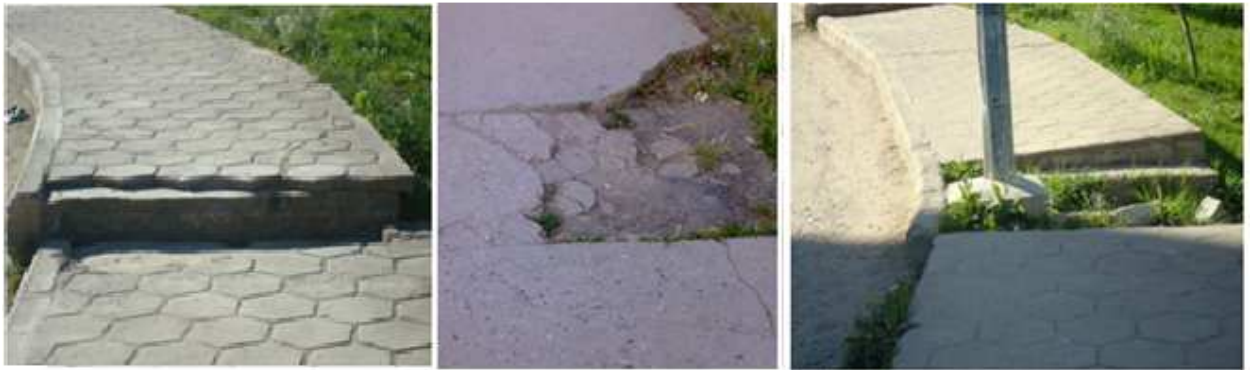
Figure n° 112 la réalisation des trottoirs ne répond pas aux exigences de confort
