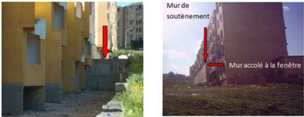
Figure n° 91 Murs de soutènements exécutés à l'encontre de l'esthétique et de l'usage Source : Auteur
