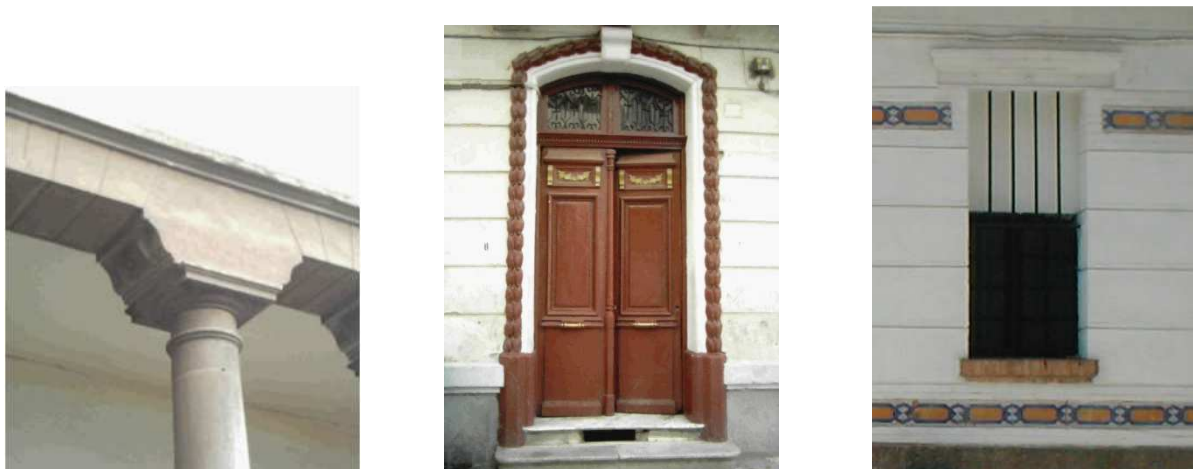
Figure n°233 Détails architectoniques très esthétiques qui participent à rendre l'espace urbain plus durable. Source : auteur et DAU
