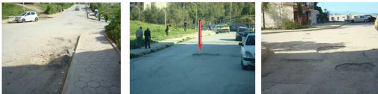
Figure n° 111 Détérioration de la chaussée. Source : auteur
