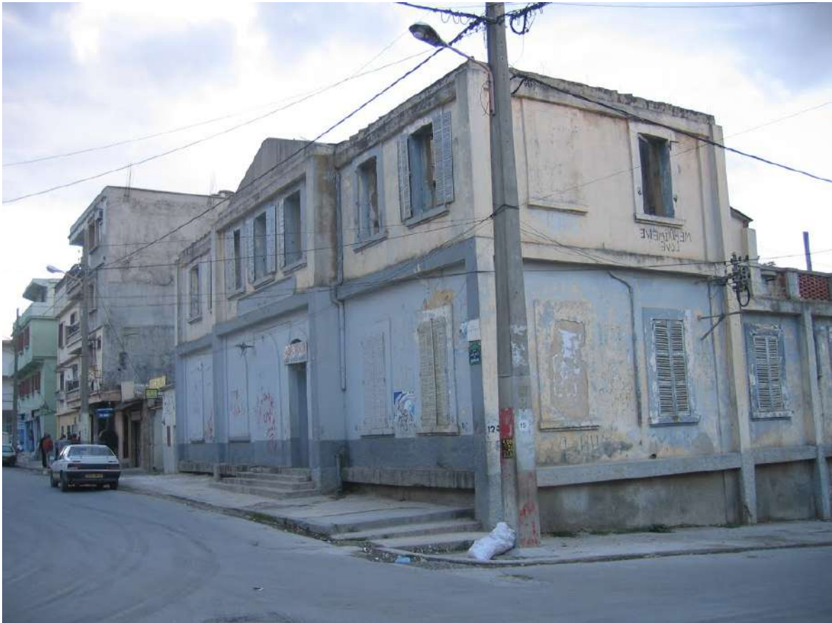
FIGURE III.15 – Photo d’une ancienne construction vétuste en dégradation,Source : site web : https://mapio.net
