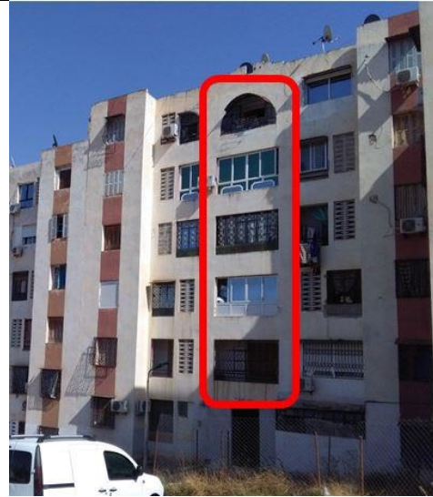
Figure 8.5 : L'utilisation du barreaudage et des volets métallique vérandas dans les balcons et le séchoir. Source : Auteurs, 2018
