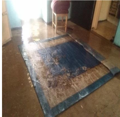
Figure 8.7 : Palier de la cage d'escalier devenue laverie de tapis. Source : Auteurs, 2018
