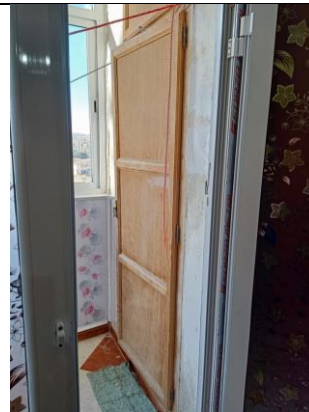
Figure 7.26 : La création des placards muraux dans le balcon du séjour. Source : Auteur, 2018
