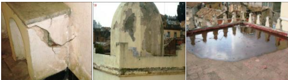
Figure N° 6 (7 et 8 et 9) : diagnostic de l'état de la medersa, Source : Groupement CFE Readymade 2014.
