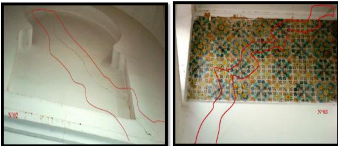
Figure N° 6 (5 et 6): Fissure de cisaillement en diagonale apparente sur un mur de façade et faïence intérieur; source: Groupement CFE Readymade 2014.
