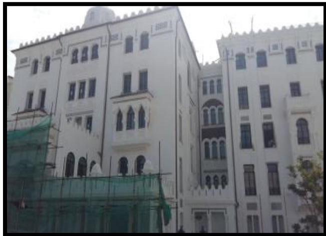
Figure N° 5.18 : hôtel Cirta (les travaux dans l'hôte Cirta sont arrêtés jusqu'à nos jour 25/12/2020),source: auteur (05/09/2019).
